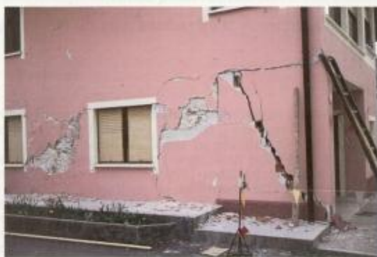
Sl. 44. Globoke razpoke v konstruktivnih in nekonstruktivnih elementih novejšega stanovanjskega objekta, grajenega iz opeke z armiranobetonskimi (AB) stropovi so značilne za VII. - VIII. stopnjo EMS. Omenjene poškodbe 4. kategorije so nastale na številnih objektih v Mali vasi pri Bovcu.
