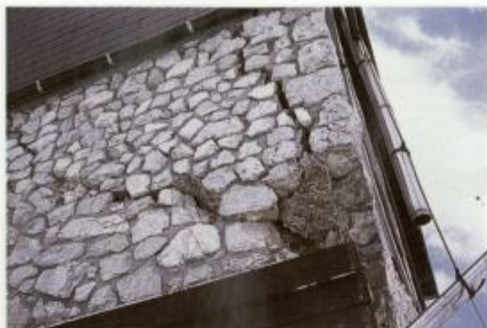
Sl. 26. Zmerne do hude poškodbe (3. kategorije), predvsem velike in globoke razpoke v stenah grajenih iz neobdelanega kamna, so nastale v SKI hotelu na Voglu in so značilne za VI - VII. stopnjo EMS.
