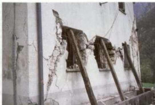
Sl. 43. Globoke razpoke v vseh nosilnih stenah in delna porušitev vogalov konstrukcije (poškodbe 4. kategorije) so značilne poškodbe objekto iz neobdelanega kamna pri VII. - VIII. stopnji EMS. Zaradi poseđanja etaze so se porušile vse predelne stene v pritličju. Primer sirarne na planini Polog nad Tolminko v neposredni bližini Osojnice.
