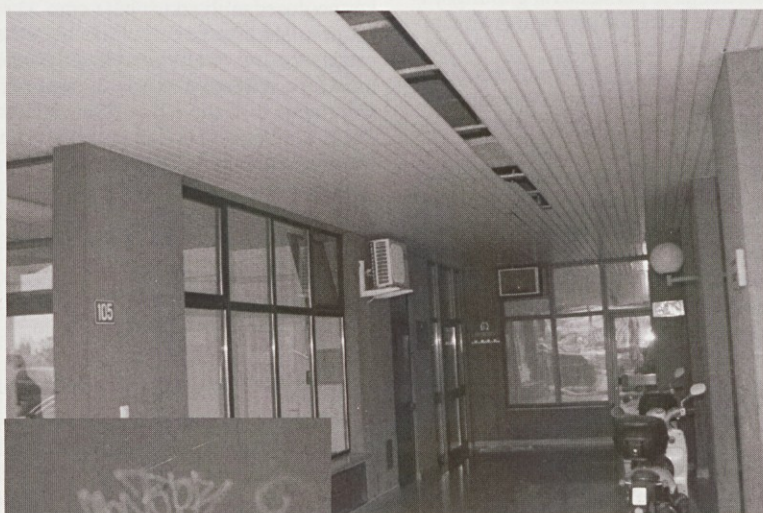
Res malce neugleden vhod. Na stropu manjkajo letvice, stene so popisane.
