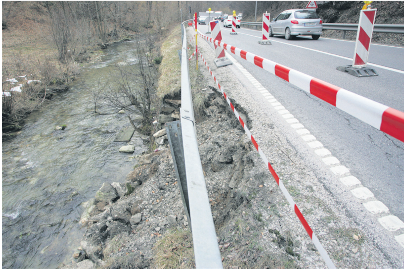
Cesta Arja vas–Velenje pri odcepu za Ponikvo je poškodovana, promet poteka izmenično enosmerno in je urejen s semaforjem, vozniki pa se jezijo.
