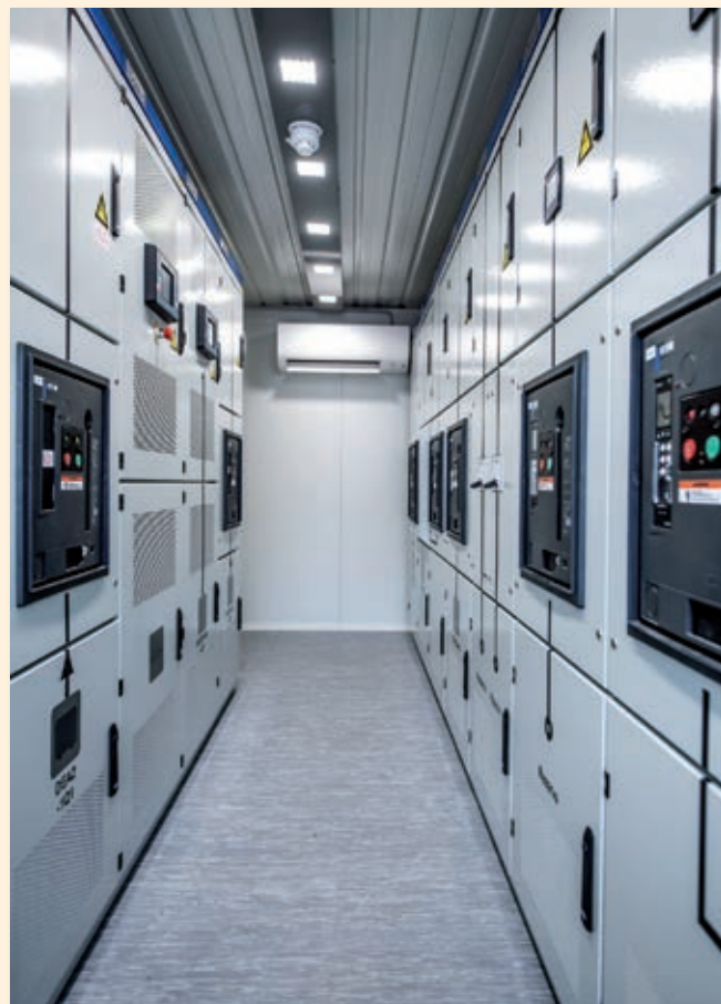
△ Notranjost podatkovnega centra Pošte Slovenija.
