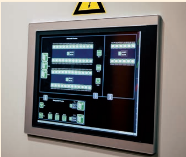
△ SCADA, nadzorni sistem v centru T-2.
