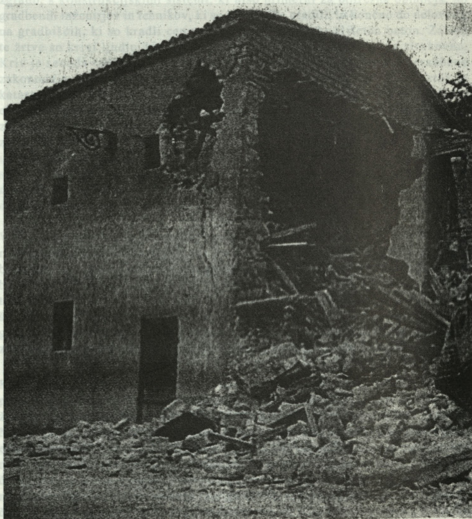
Zidana hiša brez vezi po potresu v Italiji
