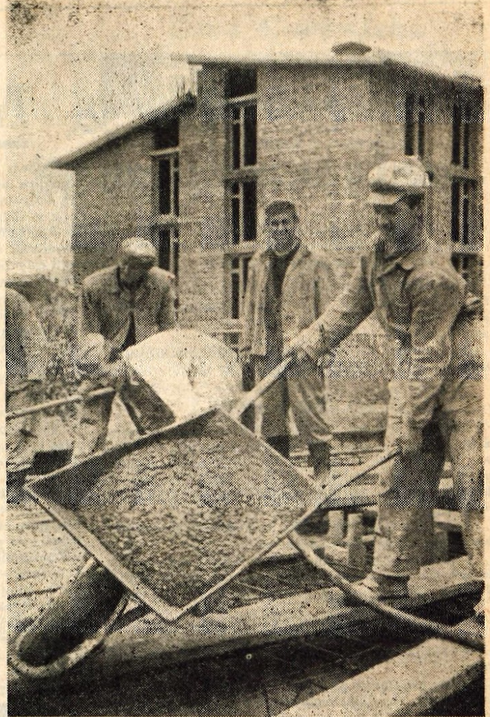
Prve stanovanjske stolpnice v Kranju (proti Zlatemu polju) so že pod streho. Foto: F. Perdan
