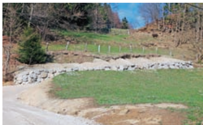
Zemeljski plaz ceste v Dolino ne ogroža več. / FOTO: OBČINA KAMNIK
