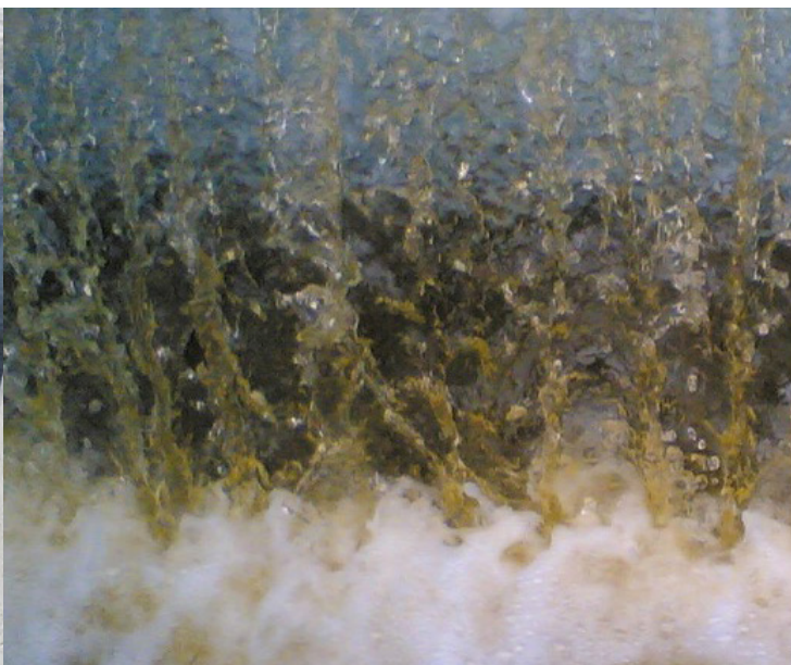
Slika 6. Rumene vsebine na iztoku iz čistilne Vir: VODOVOD – KANALIZACIJA, d. o. o.
