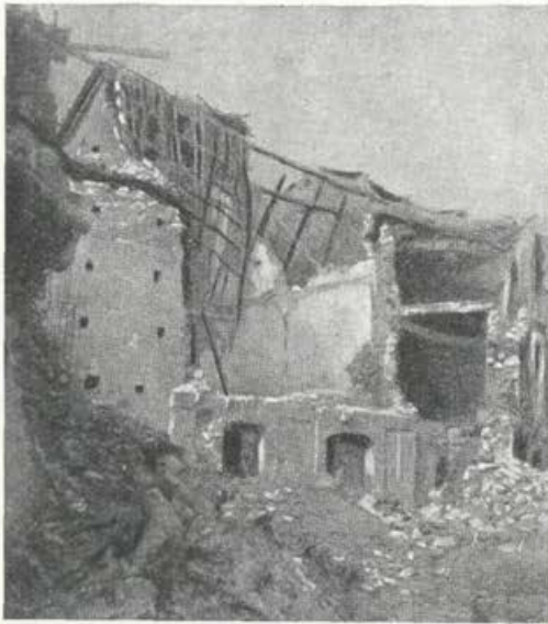
Učinek potresa na stavbe (mesto S. Procopio v Kalabriji po potresu l. 1894)
