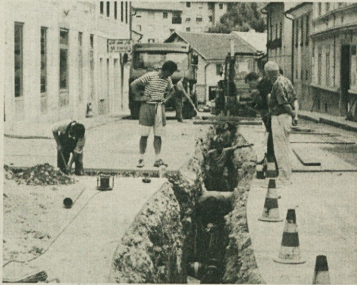
PLINOVOD ŽE NA GLAVNEM TRGU - Omrežje sevnškega plinovoda je vse dalje oz. vse bolj razvejeno. Prejšnji teden so delavci podjetja Minerva, ki je spet dobilo to delo, tokrat po javnem natečaju, na katerem je dalo svoje ponudbo kar desetero izvajalcev, položili plinovod še po Glavnem trgu (na posnetku). Te dni so razkopani trg ponovno asfaltirali. Po besedah tajnika KS Sevnica Staneta Šeska bodo te dni opravili med tržani anketo, da bi zvedeli, kdo bi želel plin na dom že to jesen. Potem bodo izvedli priključke. Da bi bilo na vrtovih čim manj škode, bodo že jeseni, najpozneje pa spomladi prekopalji še vrtove za plinovod v Florjanski ulici, na Cesti na grad in Drožanski cesti. S pomočjo delavcev pri javnih delih pa bodo naposled temeljito počistili Sevnico. (Foto: P. P.)
