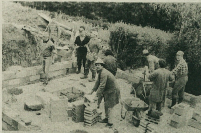
SAMI GRADIJO MRLIŠKO VEŽICO - Na šempetškem pokopališču v krajevni skupnosti Otočec so imeli le zasilo mrliško vežico. Pred dnevi so jo podrli in s prostovoljnimi prispevki in delom pričeli zidati novo. Pravijo, da bo zgrajena še letos. Imela bo dve vežici, poslovalni plato ter kuhinjo s sanitarijami. Predsednik Jože Borse, ki se je udeležil sobotne akcije, vabi sposobne krajane, naj pomagajo pri gradnji, saj bo slej ko prej ta zadnji dom vsakdo potreboval. (Foto: J. P.)
