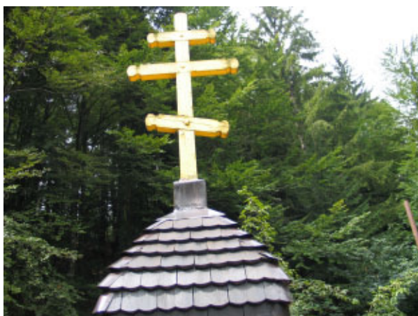
Slika 4 Poškodbe in premiki zaradi zamakanja in trohnenja nosilnih konstrukcij zvonikov (foto arhiv ZVKDS).
