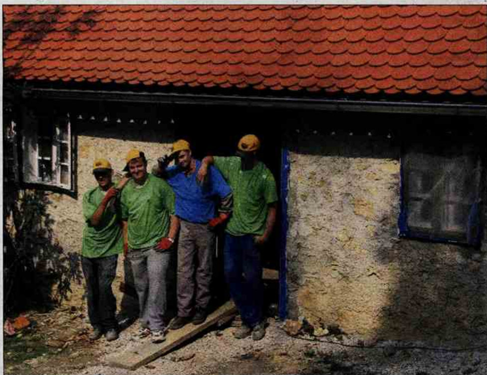
Dela pri obnovi Almine hiše so opravljali dijaki, ki se izobražujejo za poklice zidar, tesar ter izvajalec suhomontažne gradnje pod mentorstvom učiteljev v okviru ur praktičnega pouka v srednji šoli za gradbeništvo.
