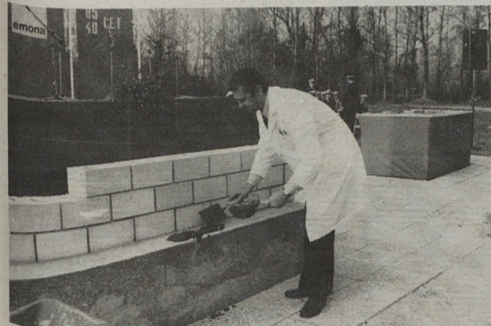
V Čatežu ob Savi so 21. oktobra 1977. leta položili temeljni kamen za nov hotel Terme, vzdal ga je dr. Anton Franovič, vodja zdravstvene službe čateških toplic.
