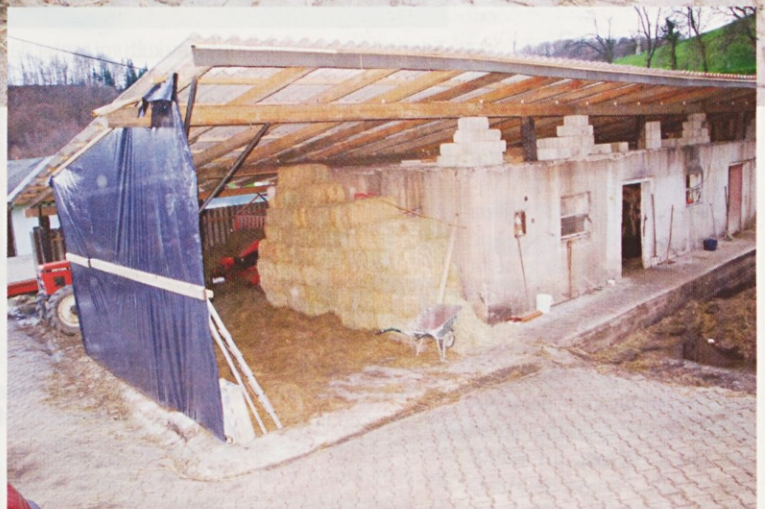
Po požaru so uredili zasilno zatočišče za živali. Nekaj krme je gospodarju ostalo še od lani. Čez nekaj tednov je bo zmanjkalo.
