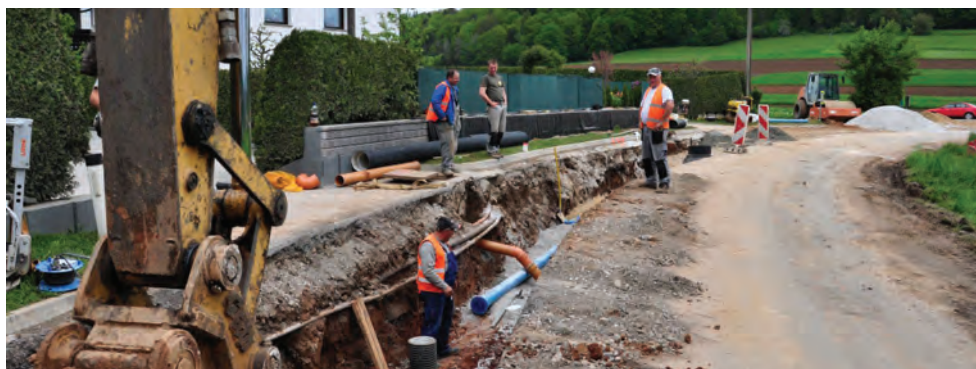
Dela za izgradnjo kanalizacije in nadgradnjo centralne čistilne naprave potekajo po planu.
