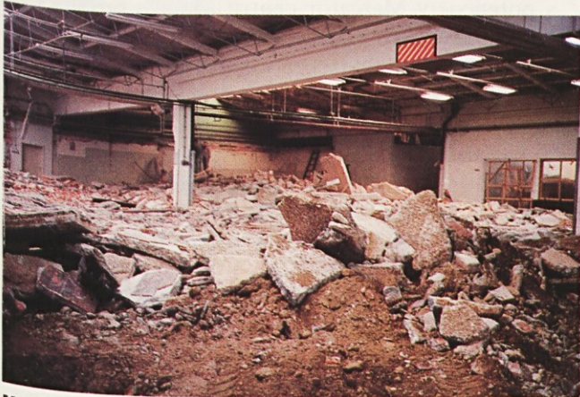
Nad proizvodno dvorano je ostala samo streha
