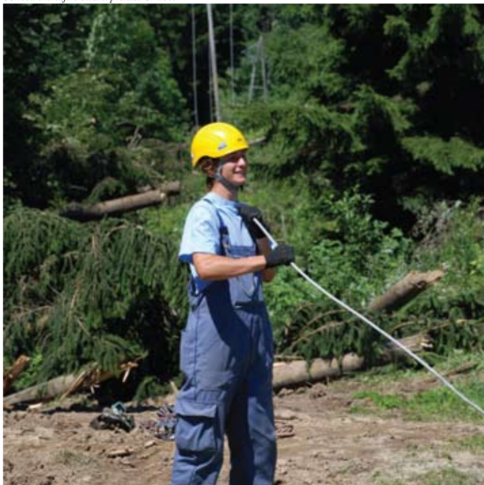
Foto arhiv Elektra Ljubljana
