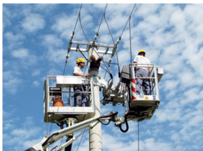
Foto: arhiv Elektra Gorenjska
