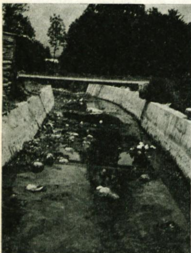
Tako izgleda kanal Mlinščice, kadar v njem ni vode
