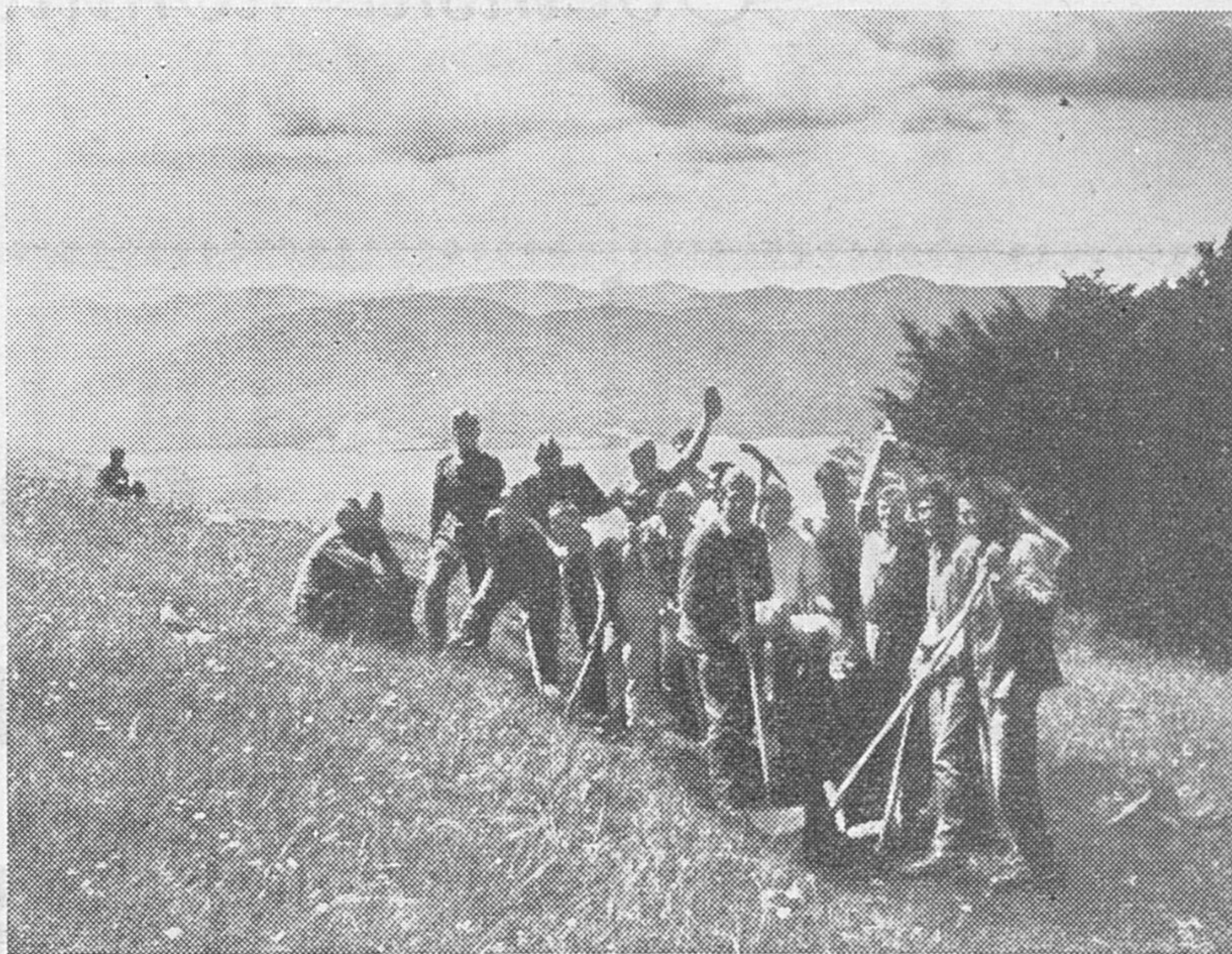
Delovna akcija ob začetku gradnje pionirskega doma na Slivnici. Sodelovanje pripadnikov JNA
