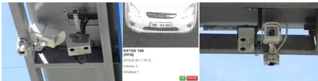
Slika 1-3: Kamere za samodejno razpoznavanje registrskih tablic nameščene na portalni konstrukciji nad voziščem
