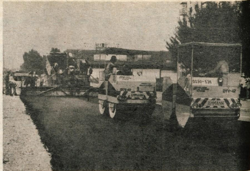
ASFALTIRANJE CESTE PROTI KOKRICI — Cestno podjetje iz Kranja je začelo v sredo vgrajevati fino asfaltno prevleko na Cesti JLA od Kranja proti Kokrici. Ker delo dobro napreduje, je bil včeraj že vgrajen asfalt do mostu na Kokrici. (jk) — Foto: F. Perdan
