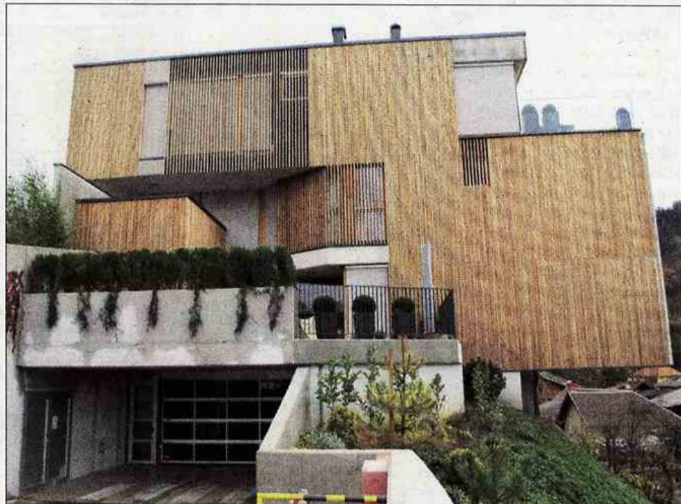
Zaradi pregloboko izkopeno gradbene jame na strmem terenu naj bi varnost dva milijona evrov vrednih luksuznih stanovanj kar trikratno povečali in tako prepričali strokovno javnost, da sta vili vredni priznanja.
