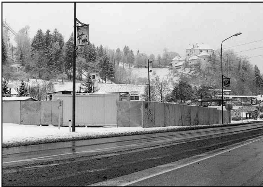
Za varnostno ograjo, ki je pred kratkim »zrastla« na zelenici med bencinsko črpalko in Policijsko postajo Velenje, poteka obnova porečja podtalnice Trebušnice, ki na tem mestu priteče iz podzemlja. 650 metrov dolga trasa reke teče pod mestom in je močno dotrajana, zato bo obnova dolgotrajna. Izvaja jo HTZ.
