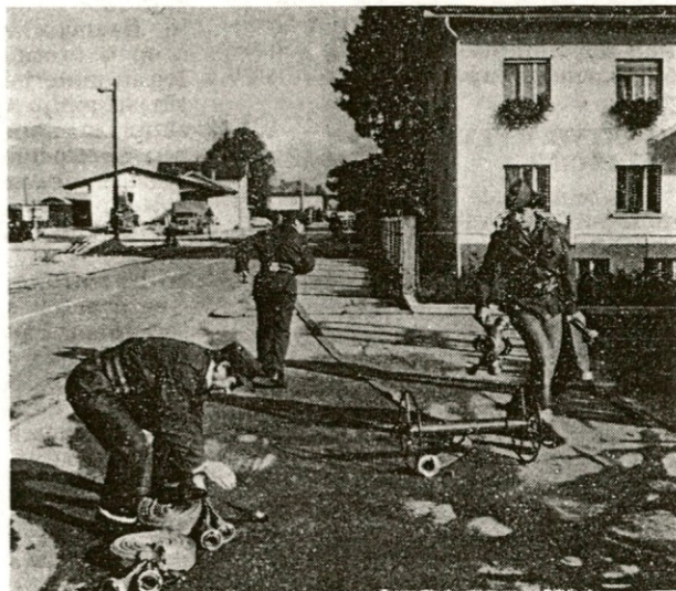
Polaganje tlačnega cevovoda pri dobro utečeni enoti civilne zaščite ne predstavlja posebnega problema.
