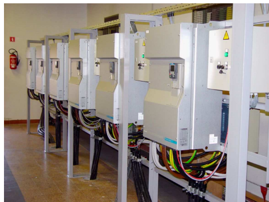
Slika 14: Instalacija šest frekvenčnih regulatorjev 250kW Figure 14: Installation of six VSD's
