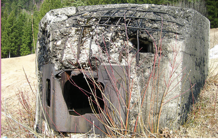
V boju močno poškodovani bunker v Mežici na Poleni
