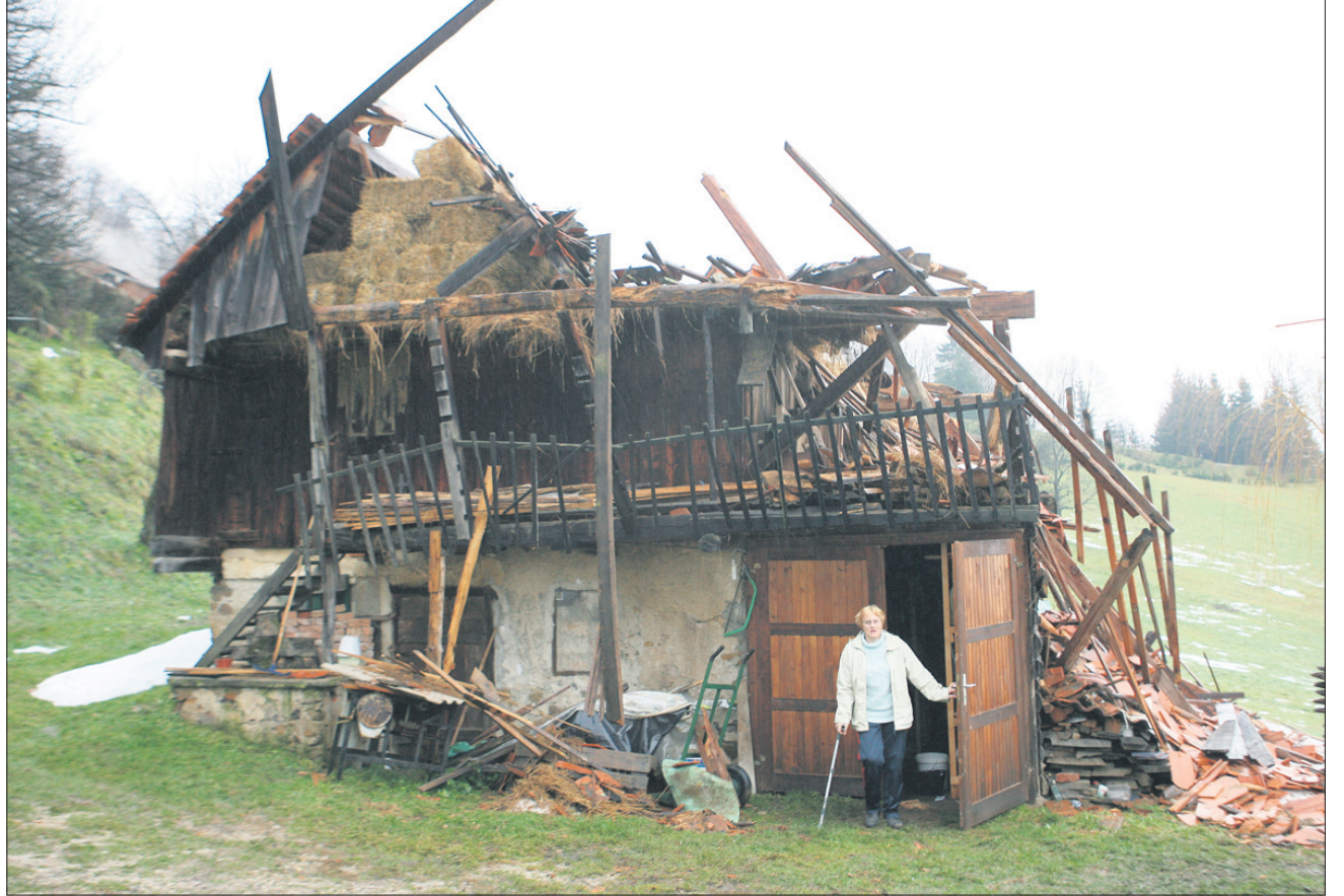
Lastnica je za pomlad načrtovala gradnjo nove drvarnice in obnovo skednja. Sneg jo je prehitel v najbolj neprimernem trenutku. »Voda teče po vseh zidovih in iz dneva v dan se dela večja škoda, jaz pa ne morem nič pomagati.«
