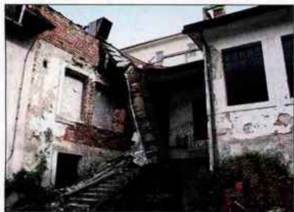
V soseščini je Pekova stavba, na kateri se je zrušila streha.
