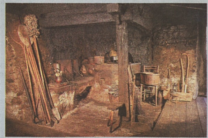
S pomočjo sredstev Evropskega kmetijskega sklada bo Občina Kamnik obnovila streho in strop črne kuhinje Budnarjeve muzejske hiše v Zg. Palovčah.
