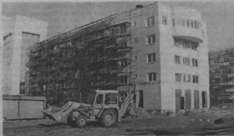
Na blokih pri Smeltu so graditelji SCT opravili že vsa zidarska dela. Ostajajo le še obrtniška dela znotraj objektov ter ureditev okolice, ki je bila vezana na gradnjo hišnih priključkov. Foto: A. G.
