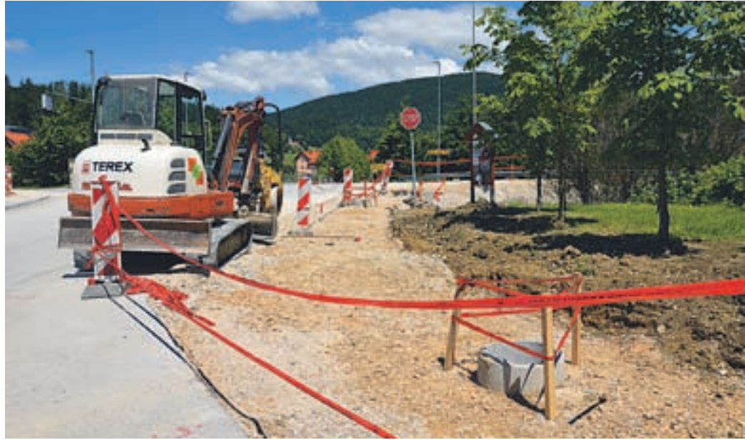
Prejšnji teden so začeli urejati nevarno križišče Obirc. Dela bodo trajala vsaj tri mesece, zato bo pot proti Celju in v dolino marsikaj nekoliko daljša.
