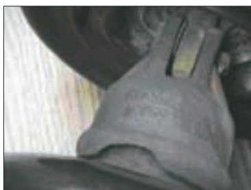
Slika 1: Poškodba na členu izolatorske verige.
