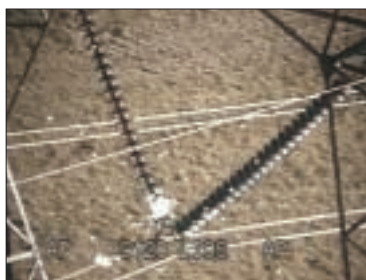
Okvara, locirana na členu v izolatorski verigi, na daljnovodnem stebri in Okvara na glavi odklopnika.
