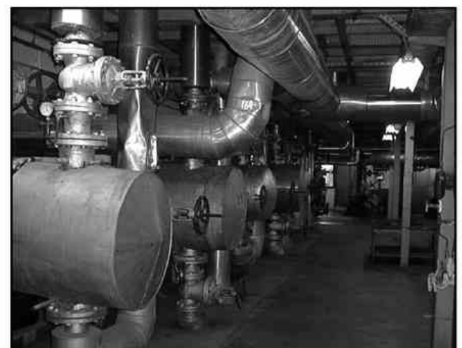
Obstoječe stanje centralne energetske postaje
