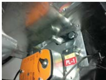
Slika 2: Napačno vgrajena požarna loputa
