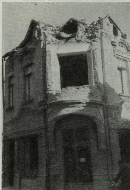
Sl. 12. Porušeni erker opečne zgradbe
