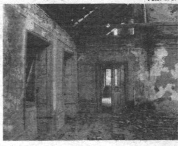
Paviliona graščine v Dolu so delno sanirali. Denar sta zagotovili Ljubljanska kulturna skupnost in Kulturna skupnost Slovenije. Sicer pa je grajski objekt zelo poškodovan. Foto: S. D.
