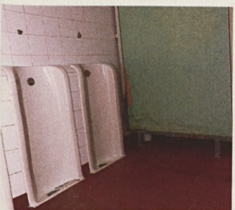
Sanitarije so v slabem stanju, saj so svinčene cevi že skoraj razpadle.
