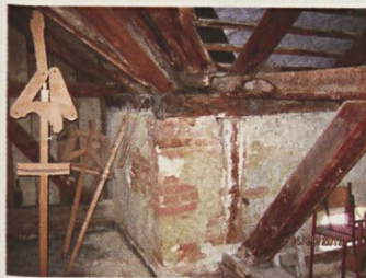
OŠ FM: Ostrešje je potrebno zamenjave.
