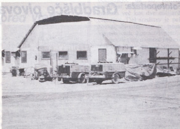
Božo Tratar, vodja vzdrževalnih obratov, je sredi libijske puščave poskrbel, da so postavili preprost montažni objekt, v katerem opravljajo vsa vzdrževalna dela na mehanizaciji.
