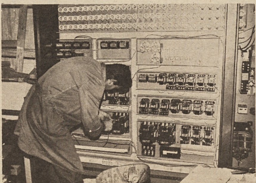
Anton Pip je zaposlen pri izdelovanju razdelilne omare za asfaltno bazo.
