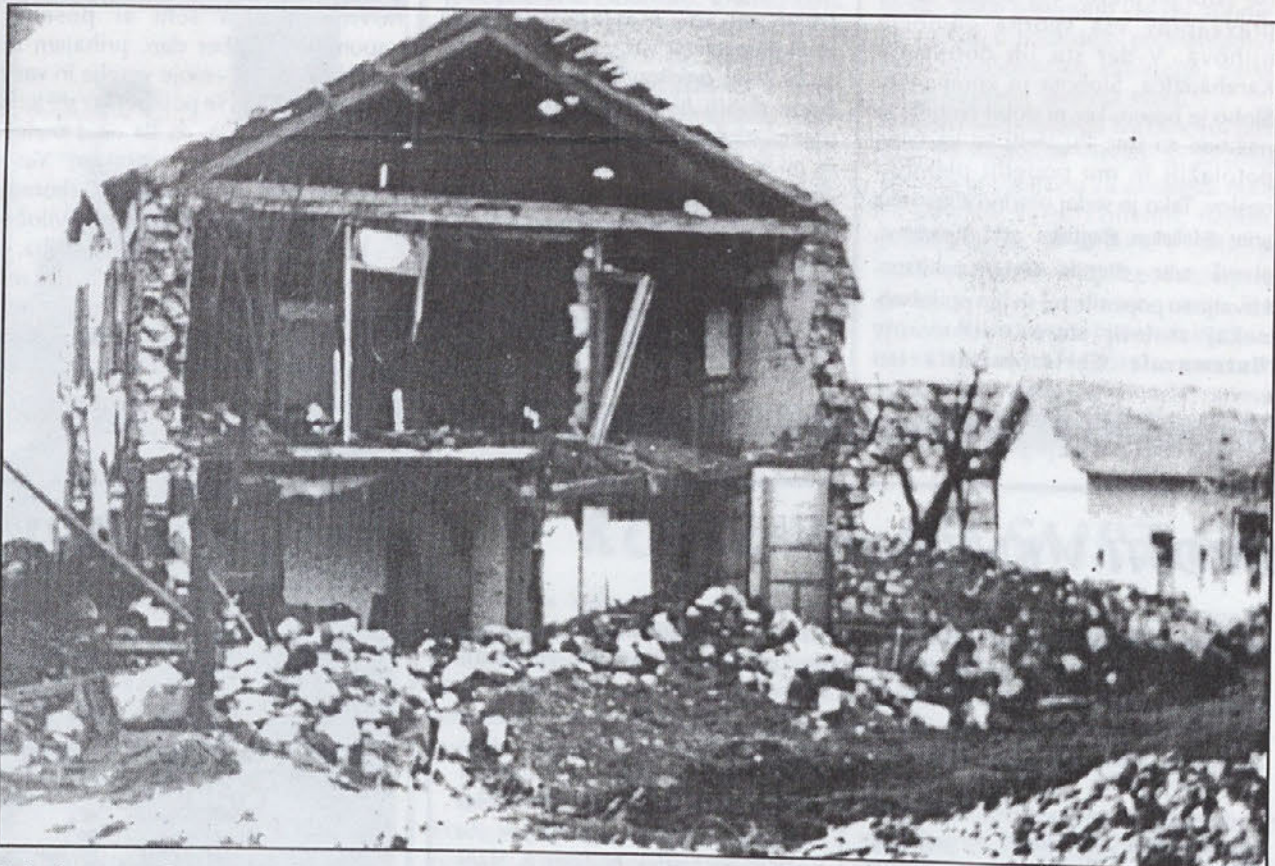
Tako je po razdejanju izgledala Bercajeva hiša (družina Hrvatini) ob Verbičevi hiši. Stavbo so morali kasneje porušiti. Kmalu po vojni so nemški ujetniki tu sezidali manjšo. Danes je na tem mestu trgovina Novi svet. Desno na sliki je Strletova hiša, ki je danes tudi ni več.
