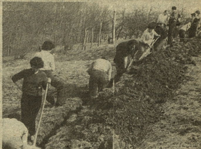
Občanom KS Ponikva je pri izgradnji vodovoda priskočilo na pomoč s prostovoljnimi delom 60 delavcev občirske uprave, družbenopolitičnih organizacij in samoupravnih interesnih skupnosti.
