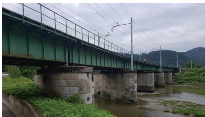
Slika 21 • Most pred sanacijo.
