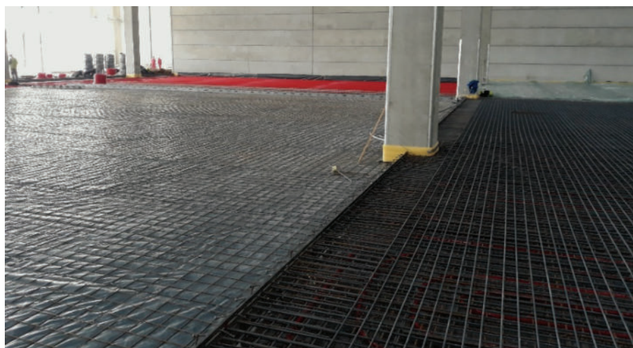
Slika 5 • Vgrajevanje drsnih membran industrijskega tlaka, razvod talnega grejja ter pripravljena armatura industrijskega tlaka.
