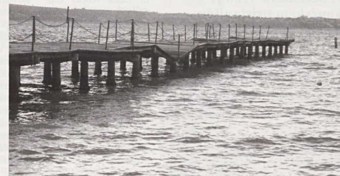
Morje je dvignilo pomole na portoroški plaži, srednjega pa celo prelomilo. Kaže, da bo vse pomole na portoroški plaži treba nadomestiti z novimi ali jih temeljito sanirati - in to še pred kopalno sezono.
