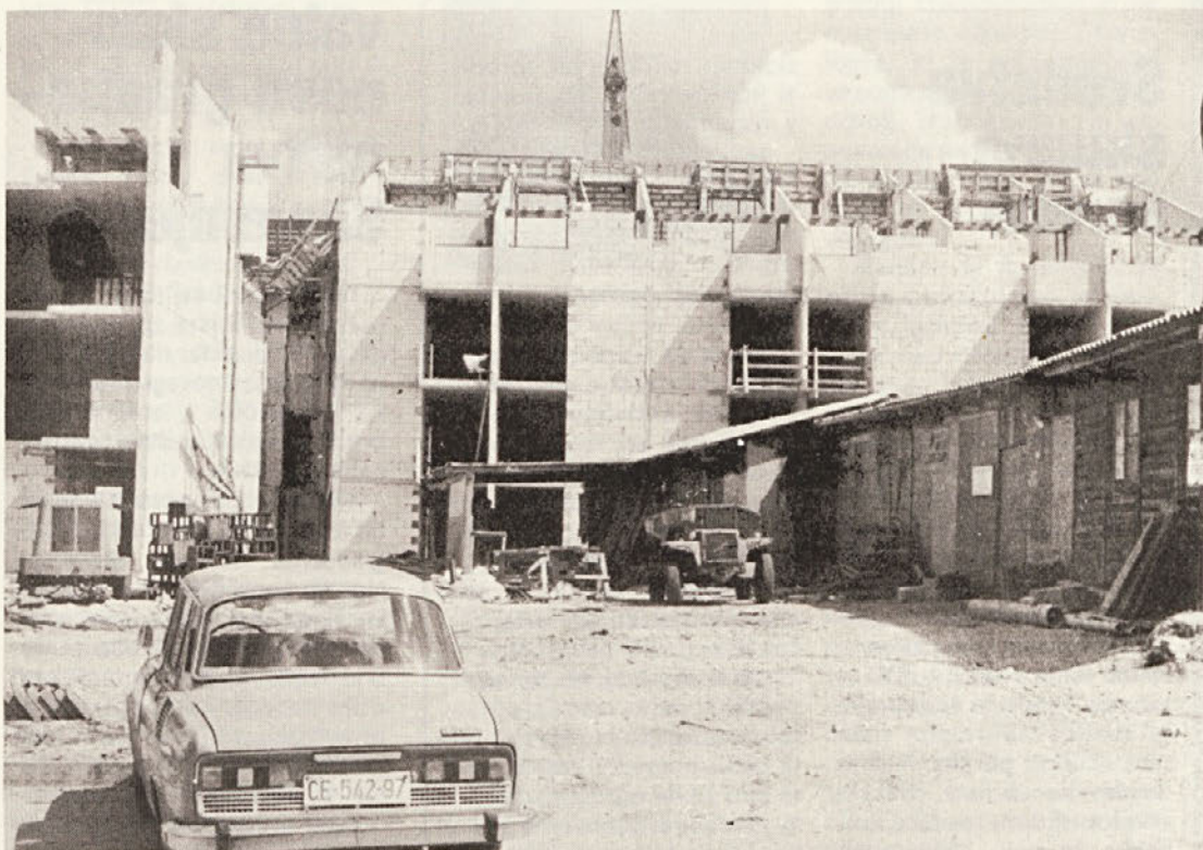
Gradnja turističnih stanovanj v Červaru v Istri (Foto: Goran Rovani) Gradnja turističkih stanova u Červaru u Istri
