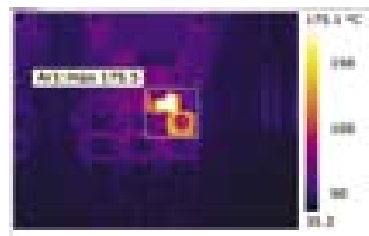
Slika 18. Termogram električnih kontaktov
