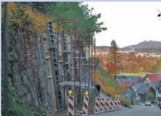
Pod pokopališčem v Sori sanirajo razpoke v opornem zidu.
