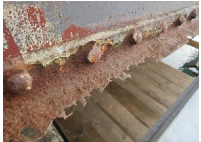
Slika 2 • Korozijske poškodbe spodnjega dela konstrukcije.
