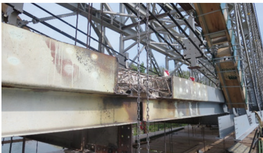
Slika 6 • Odrez dela poškodovanega spodnjega pasu in vertikale.
