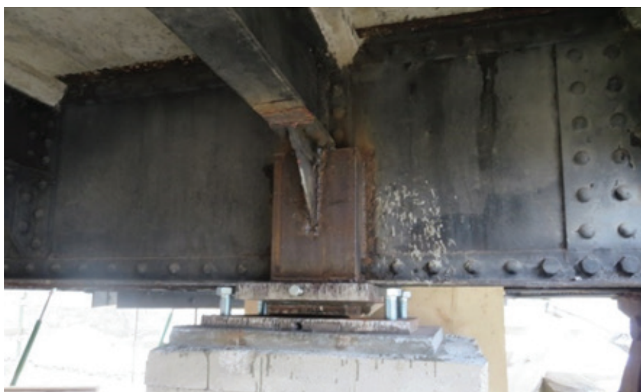
Slika 12 • Ojačitev krajnega prečnika in dodatno podpiranje.
