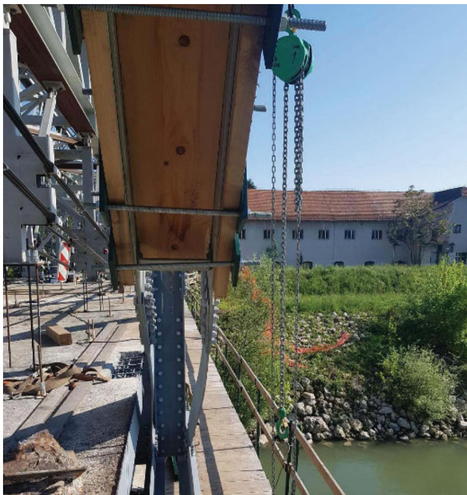
Slika 10 • Lokalni uklon pločevine natezne diagonale zaradi prezgodnje odstranitve lesene ojačitve.
