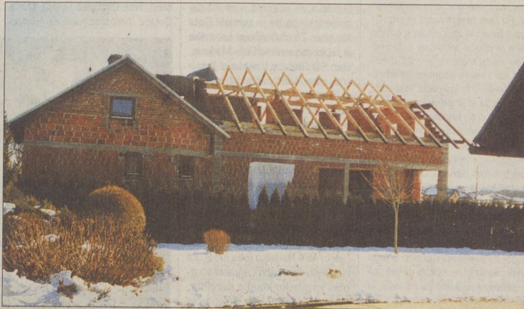
Pogled na novogradnjo Marjane Maučec na Moti s sosedove strani. Motijo jih štiri okna in odprtina na terasi, zato zahtevajo, da na tem delu stene ni oken ali večjo oddaljitve objekta od meje. – Foto: Š. S.
