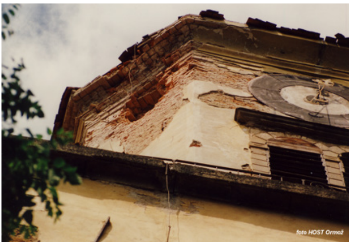
Slika 1: Poškodba stolpa ormoškega gradu, povzročena s tankovsko granato JLA (foto: Štefan Hozyan)
